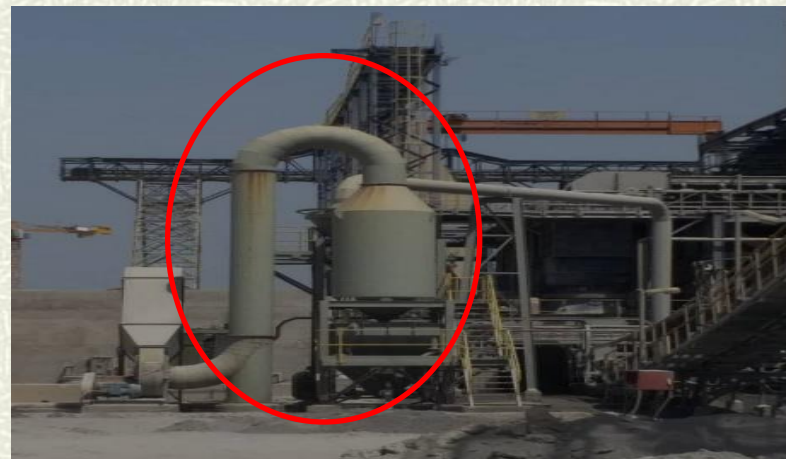
Collecteurs de poussières installés au niveau des concasseurs
