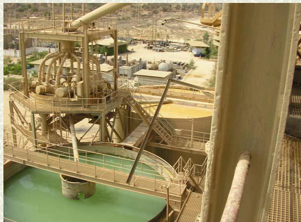
Cuves de cyanuration
